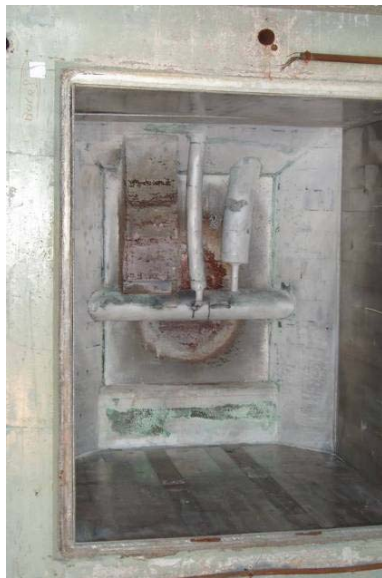
Foto 4 Termisk kolonne med udækket blynæse
