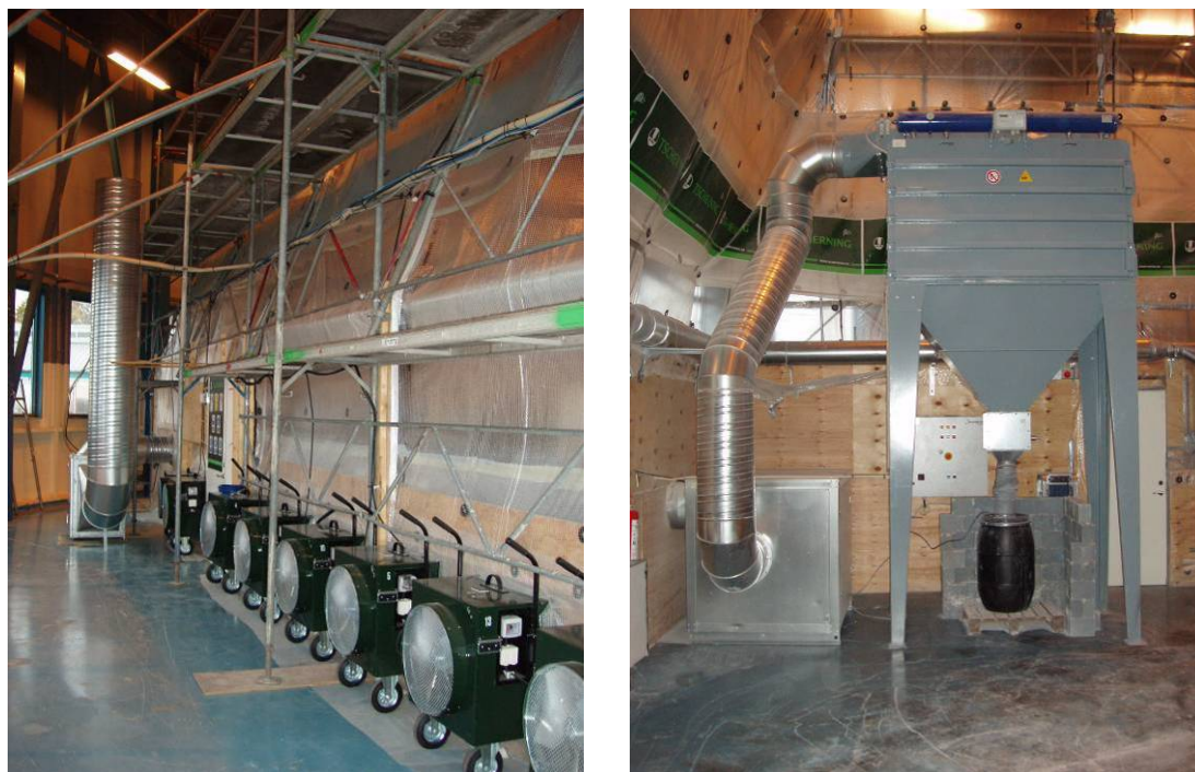
Figur 46 Venstre: Udsugningsanlæg på afkastsiden og i baggrunden afkast fra punktsug. Højre: Anlæg til punktudsug med tønde til opsamling af støv og afkast via HEPA filter.
