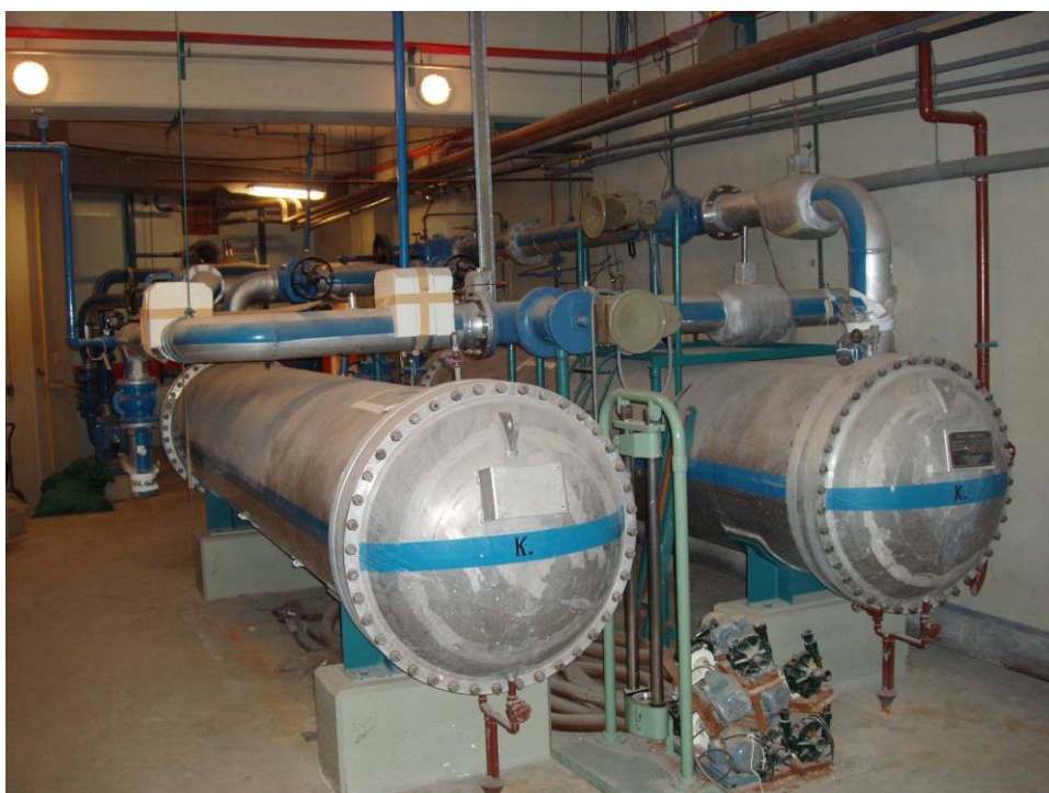
Figur 38 Varmeveksleranlæg i driftskælderen før nedtagning.
