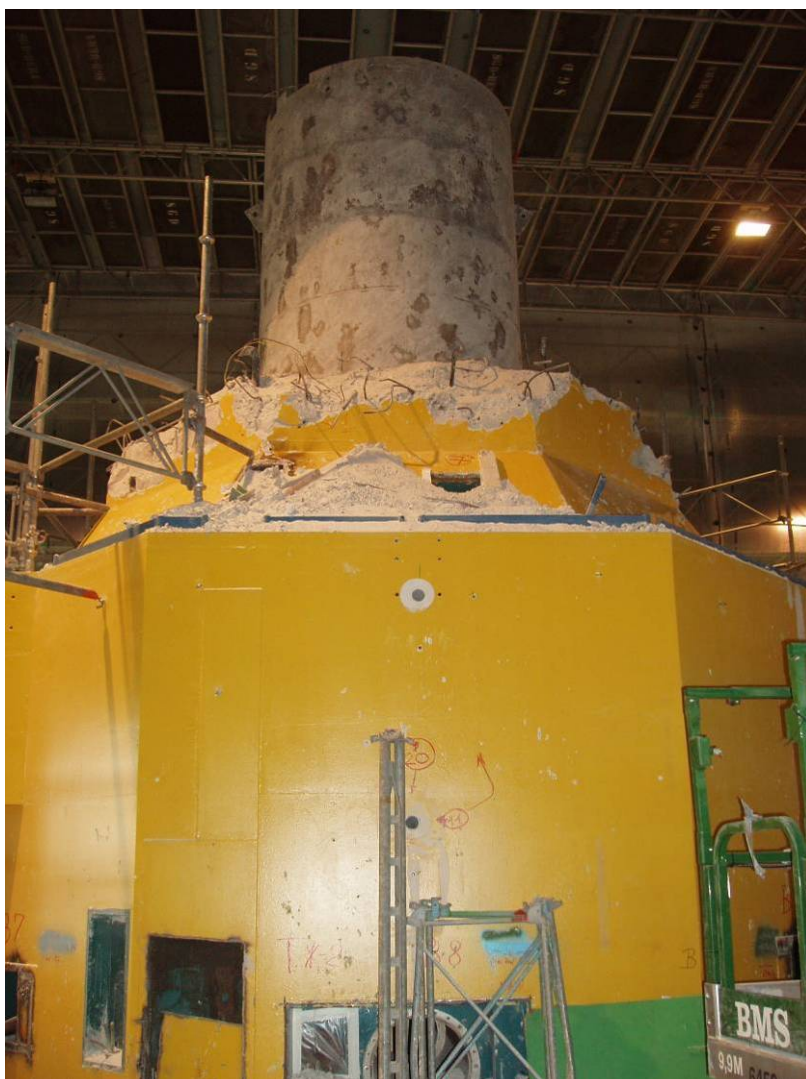
Figur 53 Skorsten nedbrudt, platform fjernes, reaktortank afventer nedskæring.
