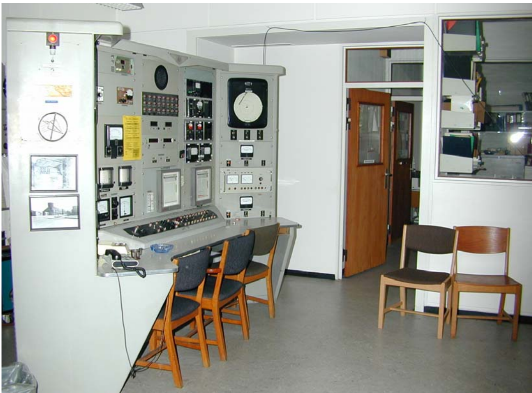
Figur 12. Interiør fra kontrolrummet. Foto fra 2004.
