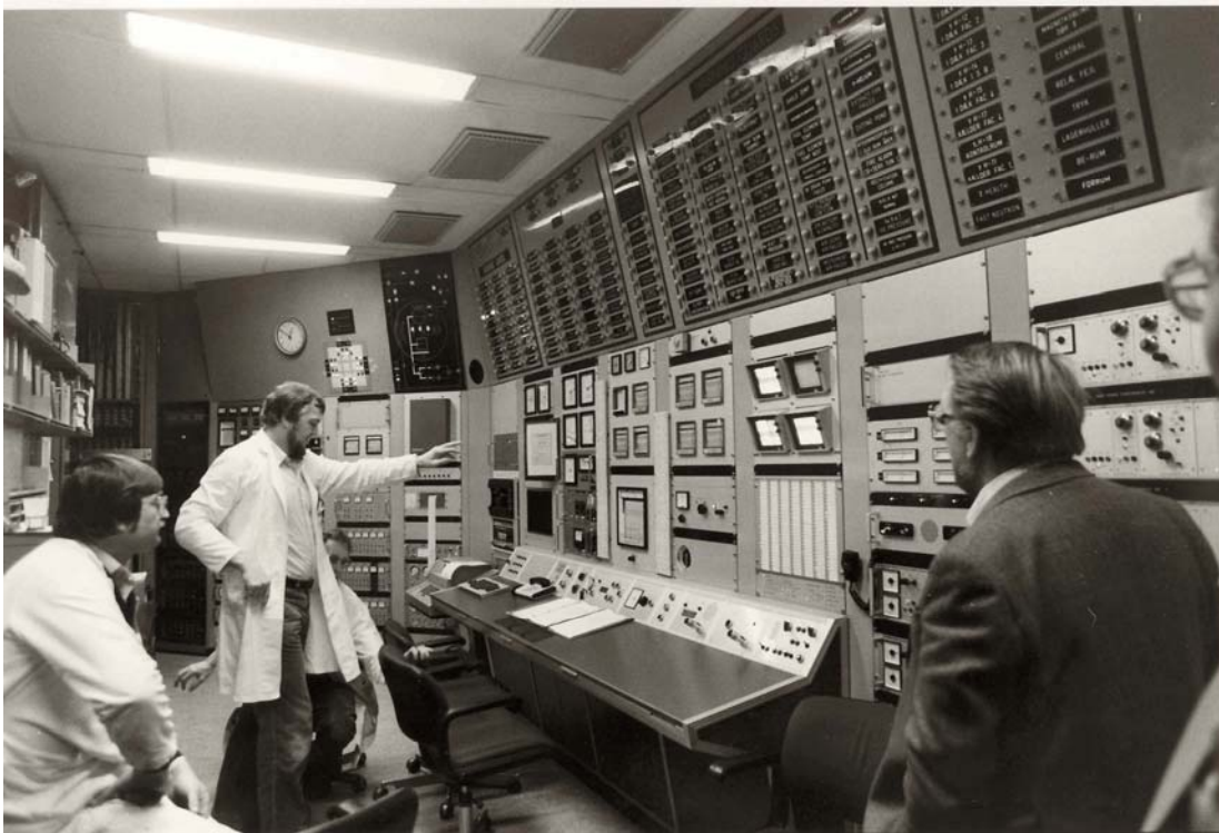
Figur 31. Diskussion i DR3's kontrolrum. Den oprindelige instrumentering i kontrolrummet blev udskiftet i årene omkring 1980. Instrumenteringen, der ses på dette billede, er anden generation og den sidder endnu i kontrolrummet. Alarmpanelerne i loftet er beskrevet i afsnit 4.4. Foto fra starten af 1980'erne.
