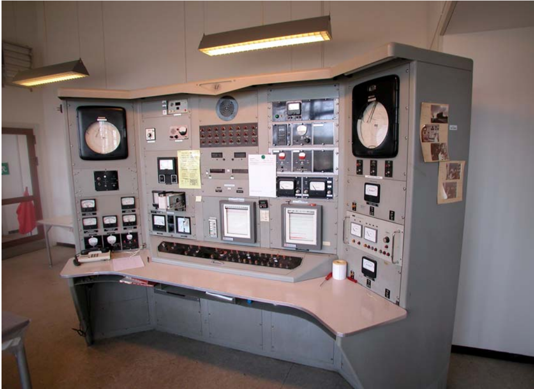
Figur 11. Kontrolpulten fra DR1, da den endnu stod i kontrolrummet. Foto fra 2003. Kontrolpulten var for stor til at komme ind gennem dørene til kontrolrummet i 1957. Arkitekten var bekendt med problemet, men han ville ikke lave om på noget, da Risø-bygningerne bestod af standardelementer. Løsningen på problemet blev, at man afmonterede listerne, hvorefter pulten kunne komme igennem. Det samme problem stødte man i øvrigt på, da man 48 år efter i 2005 skulle tage kontrolpulten ud af bygningen for at bringe den på museum.
