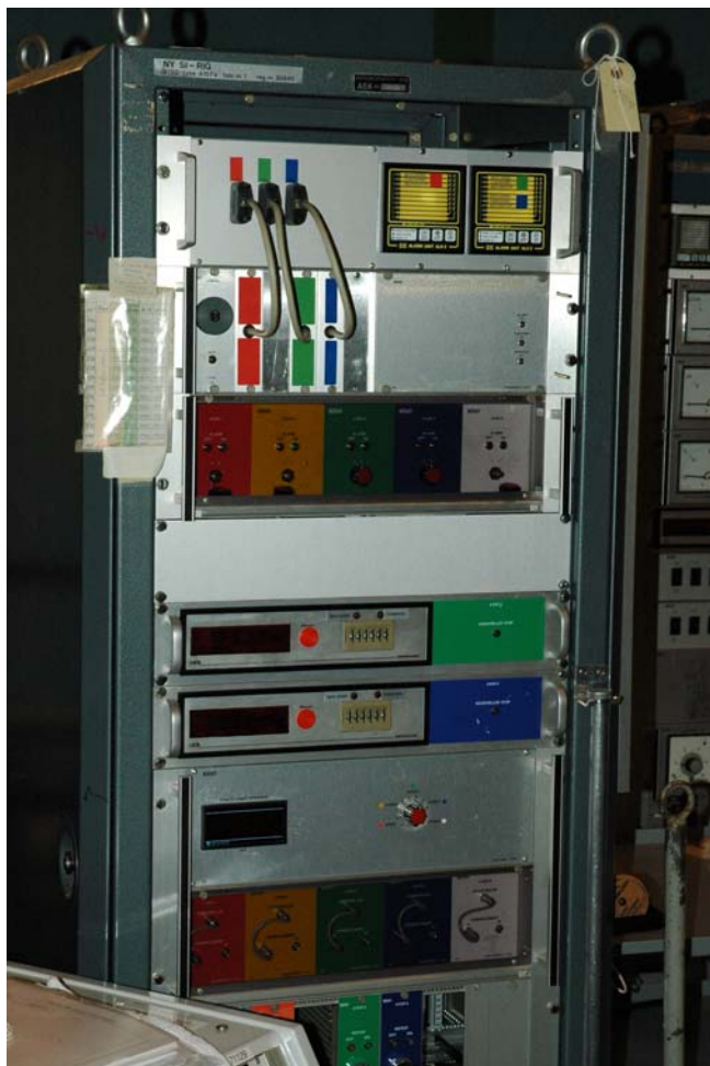
Figur 78. Silicium-rig styringspanel og tæller.
