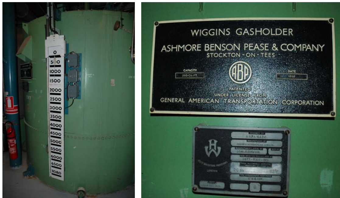
Figur 76. Mekanisk niveaumåler og skilt på Heliumbeholder (2V7).
